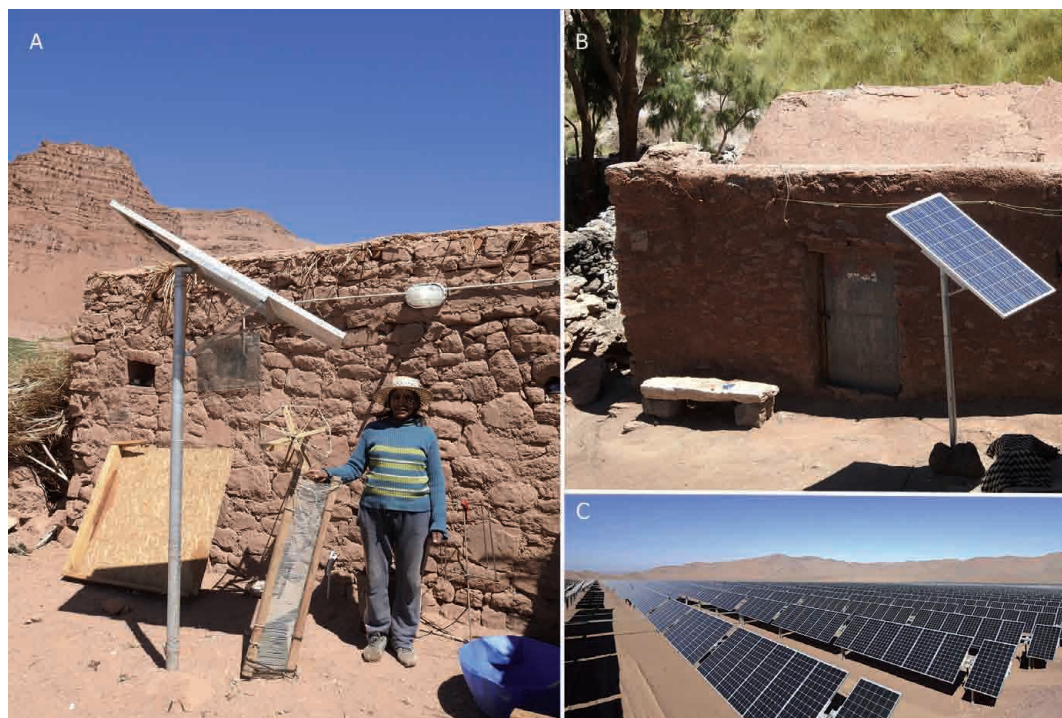
Figura 2. A y B. Sistemas fotovoltaicos domésticos del proyecto PERMER instalados en la Puna catamarqueñas, en vega Las Quinoas (3.300 msnm; 26°S) y vega Botijuela (3.500 msnm; 26°S). C. Planta solar El Romero (246 MW) de Empresa Acciona, Chile, desierto de Atacama (1.170 msnm; 29°S); es actualmente la mayor planta solar de América Latina. ( www.acciona.cl/proyectos/energia/ ). Accedido: 20/12/2017.
